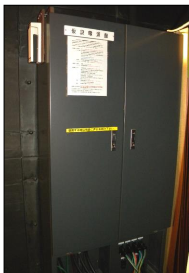
上手仮設電源(ピアノ庫横)
