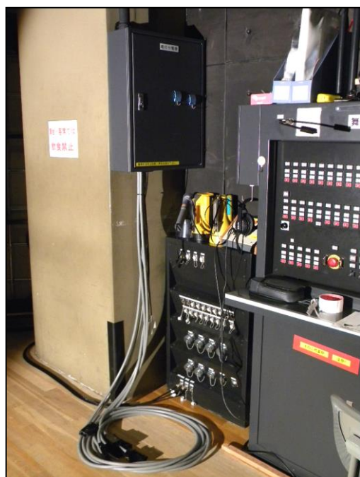
下手仮設電源(下手大臣裏)
